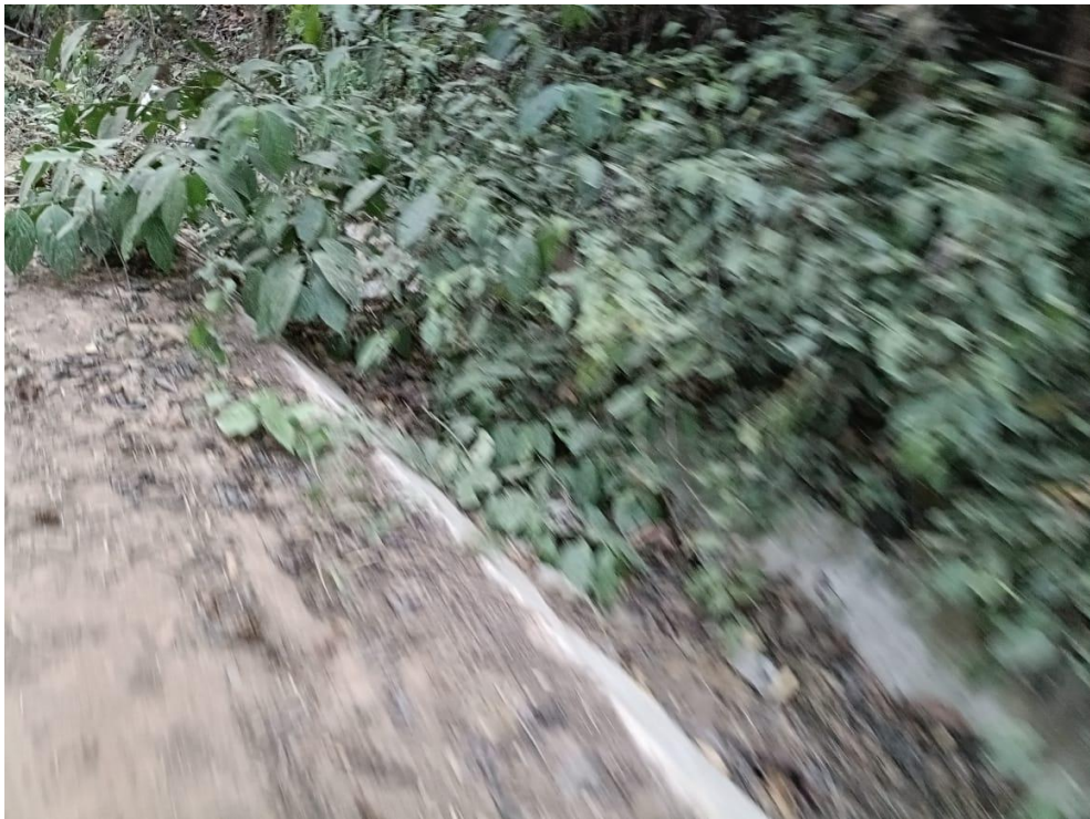
Cunetas colmatadas, que deberán ser limpiadas
