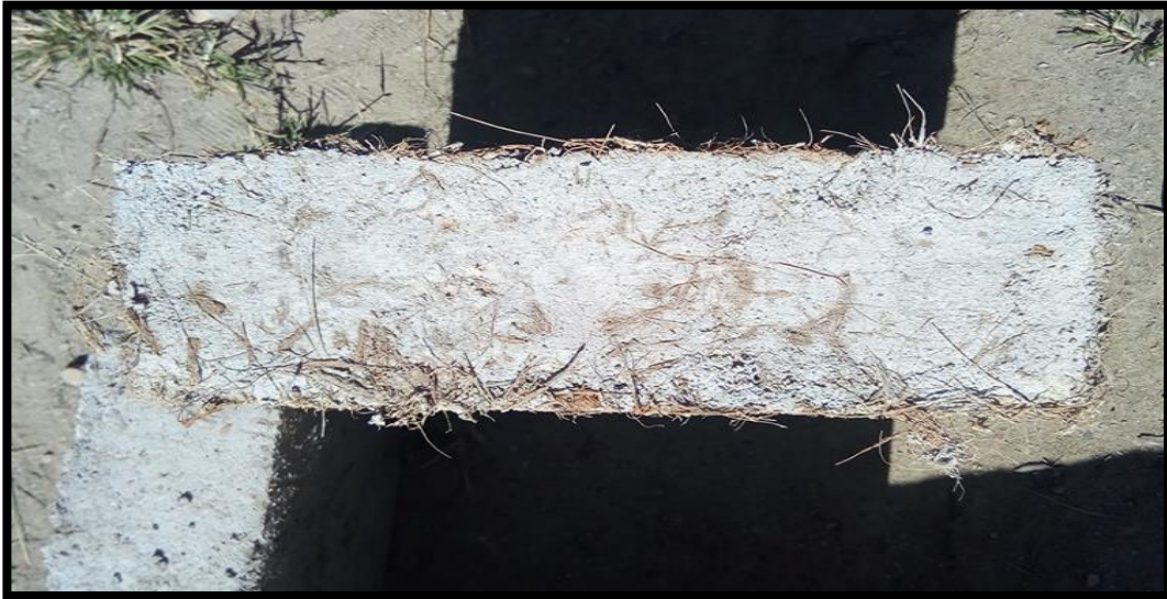
Pequeña deformación en base del ecobloque
