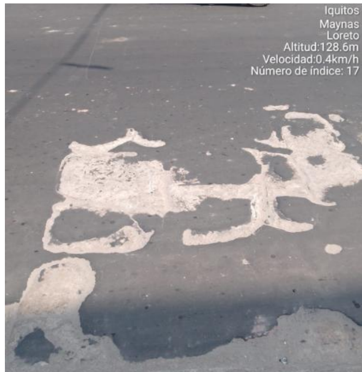
HUECO (Progresiva 0+900.00 – 0+930.00 lado derecho)
