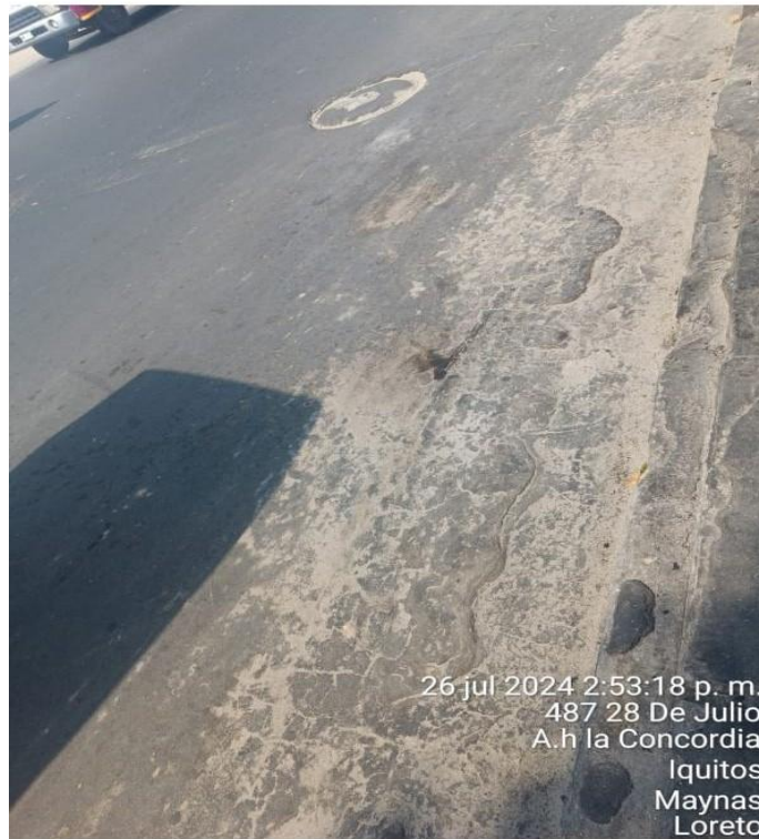
PIEL DE COCODRILO (Progresiva 0+420.00 – 0+450.00 lado derecho)
