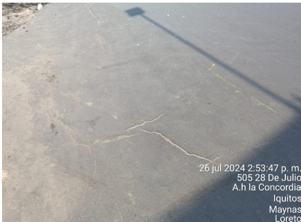
PIEL DE COCODRILO (Progresiva 0+570.00 – 0+600.00 lado derecho)
