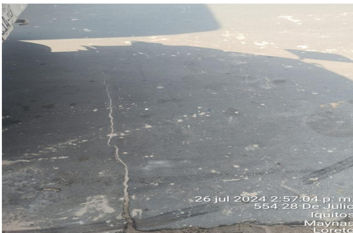
GRIETA TRANSVERSAL (Progresiva 0+660.00 – 0+690.00 lado derecho)
