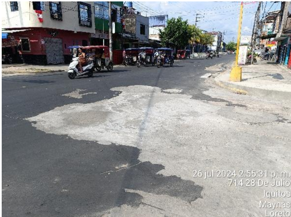
HUECO (Progresiva 0+750.00 – 0+780.00 lado derecho)
