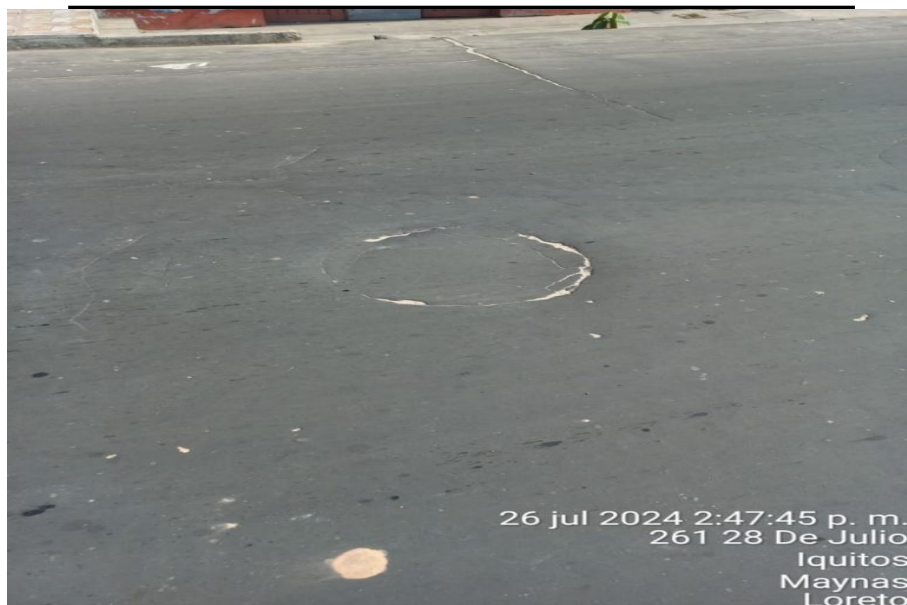
HUECO (Progresiva 0+240.00 - 0+270.00 lado derecho)
