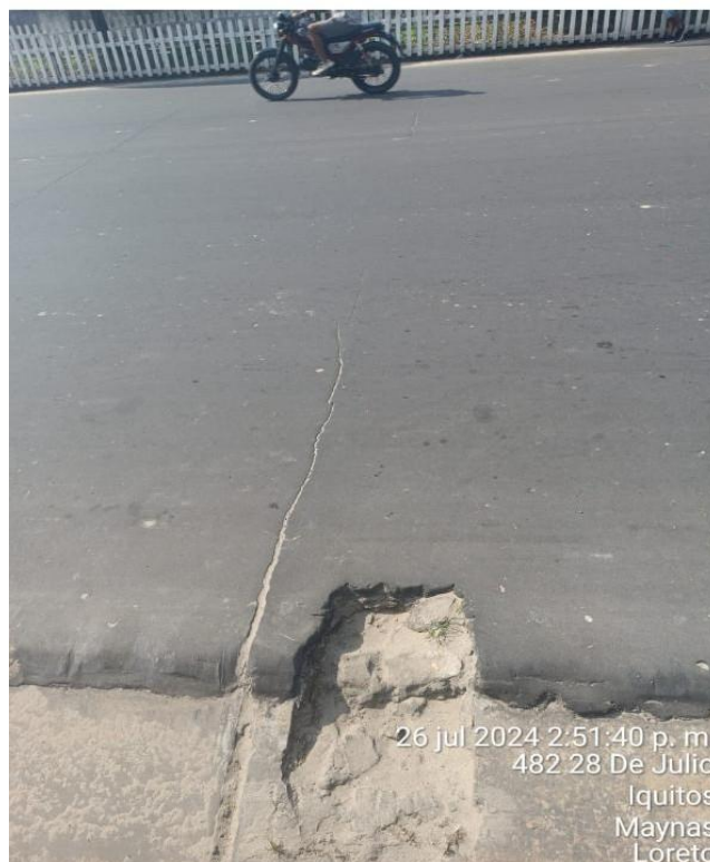
HUNDIMIENTO (Progresiva 0+420.00 – 0+450.00 lado derecho) AVENIDA 28 DE JULIO CUADRA N° 05
