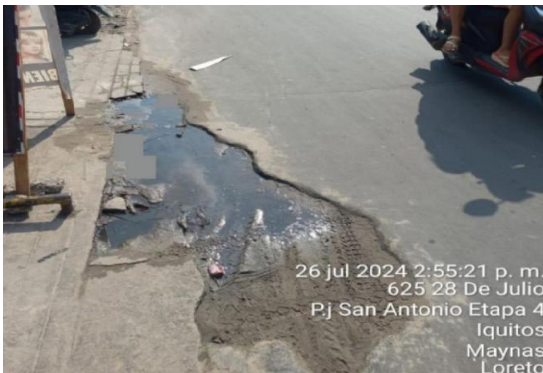
HUECO (Progresiva 0+660.00 – 0+690.00 lado derecho)
