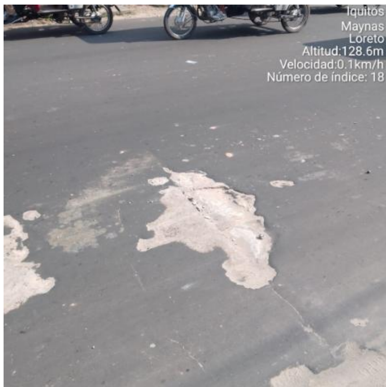
HUECO (Progresiva 0+900.00 – 0+930.00 lado derecho)
