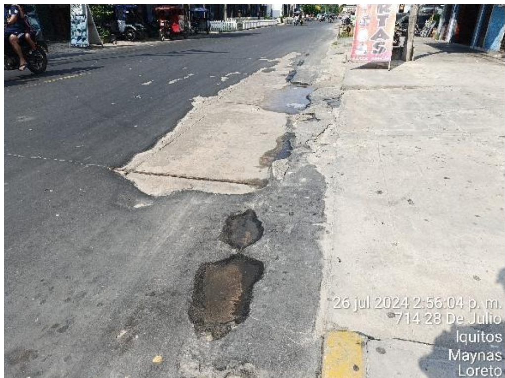
HUECO (Progresiva 0+750.00 – 0+780.00 lado derecho)
