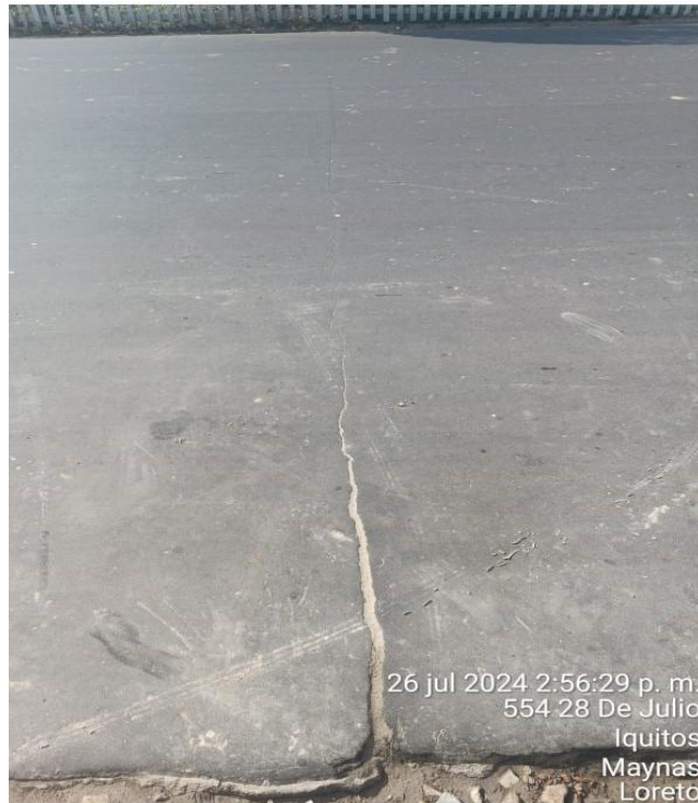
GRIETA TRANSVERSAL (Progresiva 0+540.00 – 0+570.00 lado derecho)
