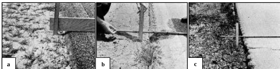
Desnivel carril – berma de nivel de severidad bajo (a), medio (b) y alto (c).
