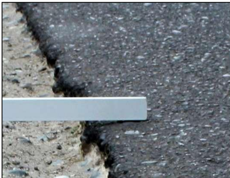
Se muestra el desnivel existente entre la berma y el carril de la pista.
