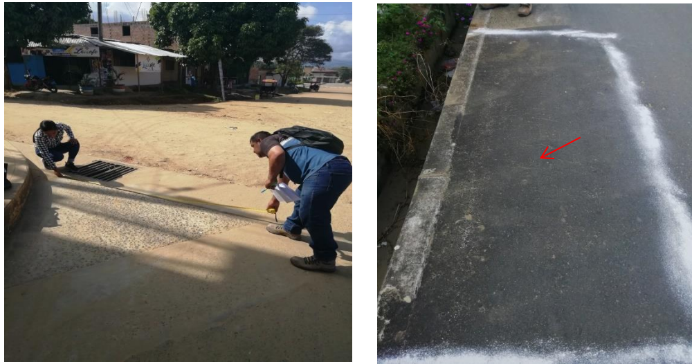
Figura 50. Testigo de defectos en el pavimento flexible
