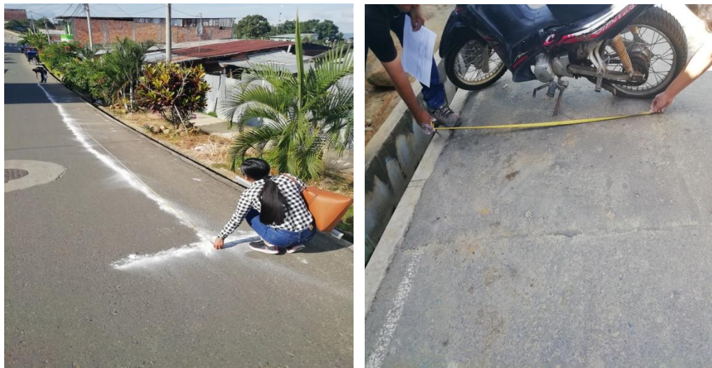
Figura 48. Testigo de defectos en el pavimento flexible.
