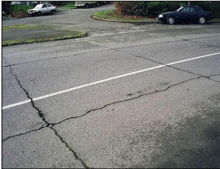
Fisura de reflexión de junta de losas de concreto: se observa una Fisura transversal que atraviesa todo el ancho del carril.
