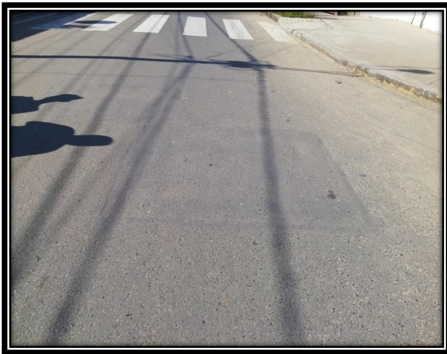
FOTO N° 06: Se observa una falla de parche en el pavimento flexible.
