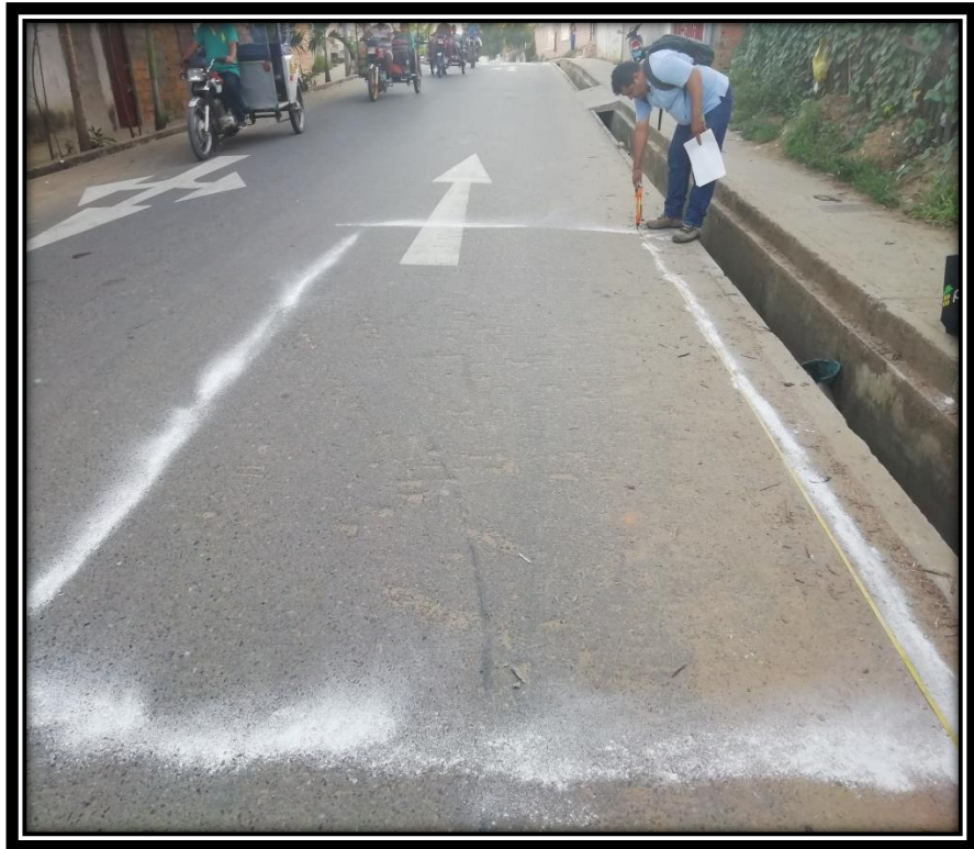
FOTO N° 05: Se observa una falla de desprendimiento de materiales.
