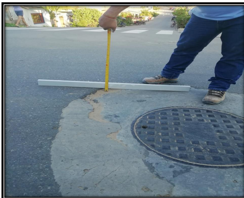
FOTO N° 02: Se observa el deterioro del pavimento flexible en un empalme.
