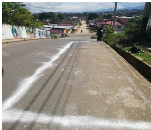
Figura 55. Testigo de defectos en el pavimento flexible
