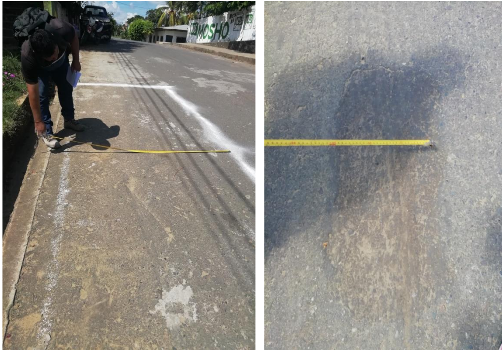
Figura 56. Testigo de defectos en el pavimento flexible
