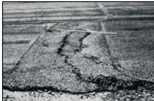
Hinchamiento de alta severidad.
