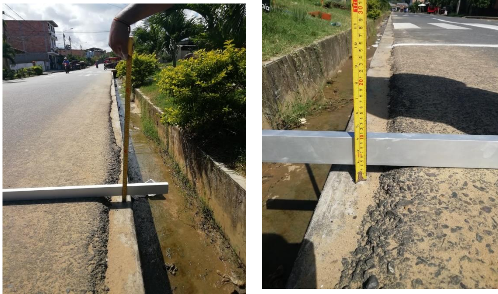
Figura 53. Testigo de defectos en el pavimento flexible.
