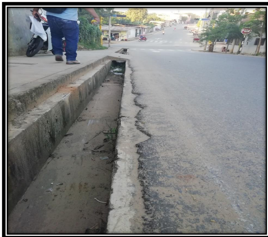
FOTO N° 04: Se observa el desnivel de berma en gran parte del tramo.
