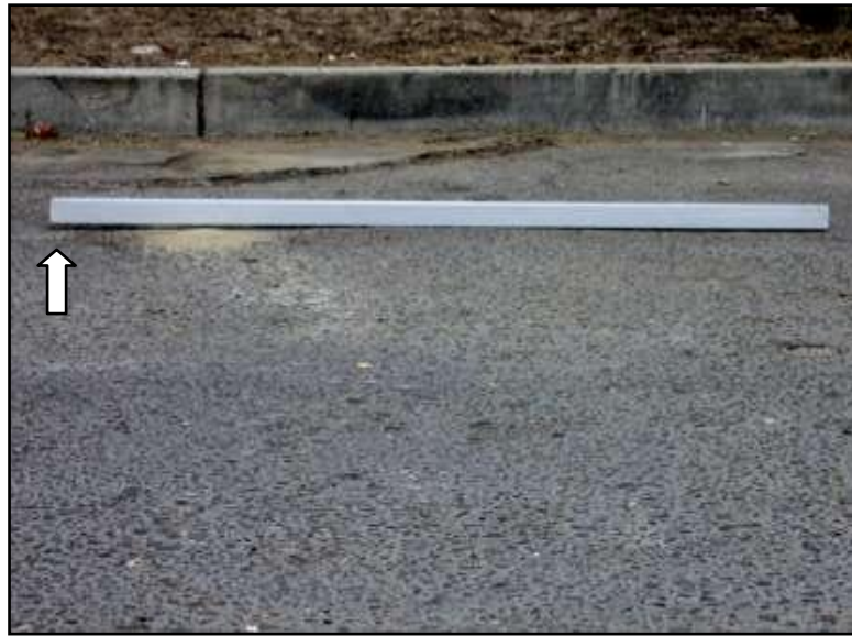
Figura 9. Abultamientos y hundimientos.
