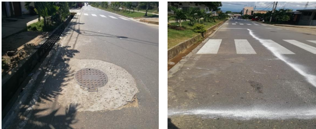
Figura 51. Testigo de defectos en el pavimento flexible
