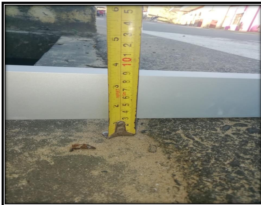
FOTO N° 01: En la vista se observa el desnivel de carril de berma.
