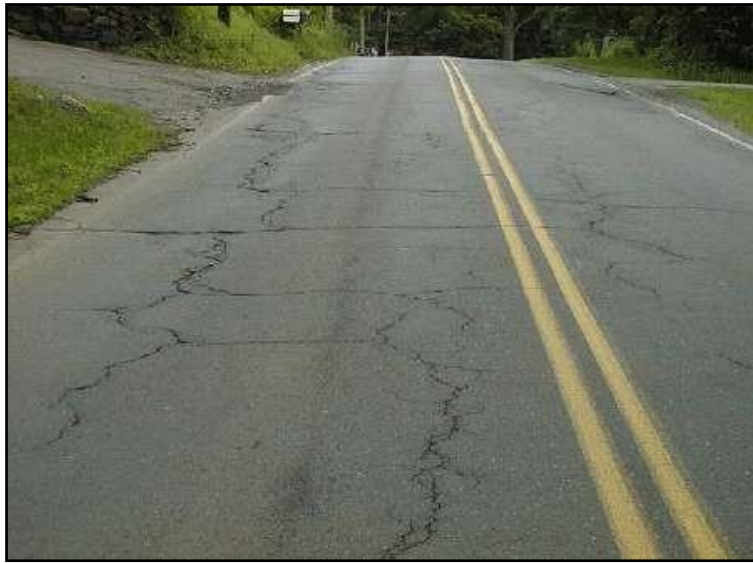
Figura 8. Fisuras en bloque.
