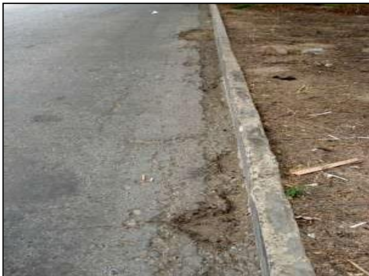
Figura 12. Fisuras de borde.
