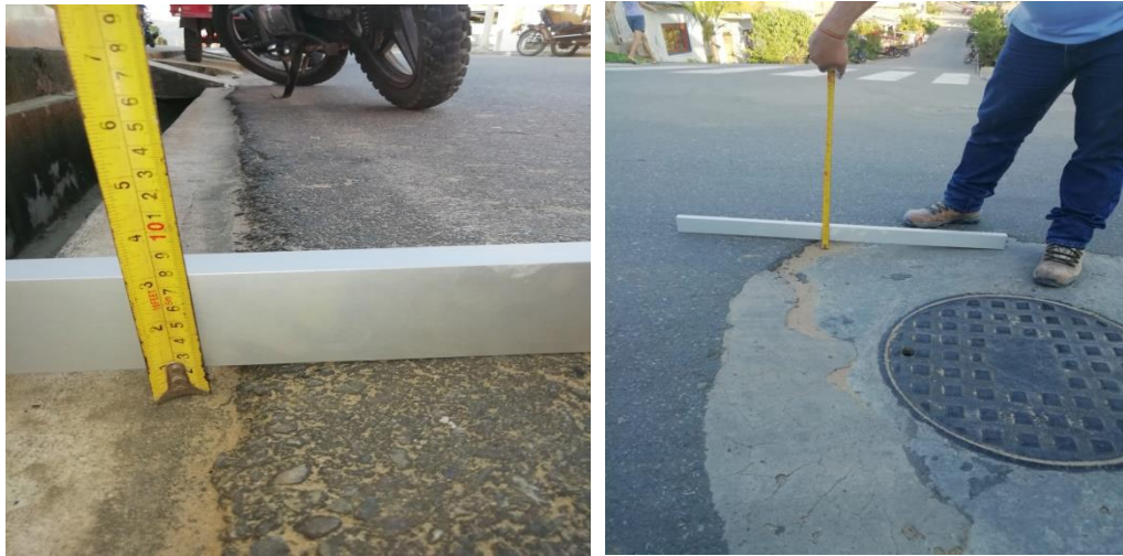
Figura 46. Testigo de defectos en el pavimento flexible
