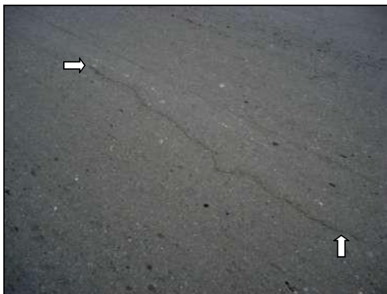
Figura 15. Fisuras longitudinales y transversales
