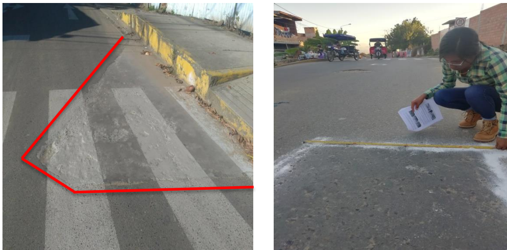
Figura 47. Testigo de defectos en el pavimento flexible
