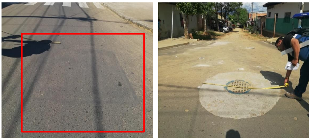
Figura 49. Testigo de defectos en el pavimento flexible.
