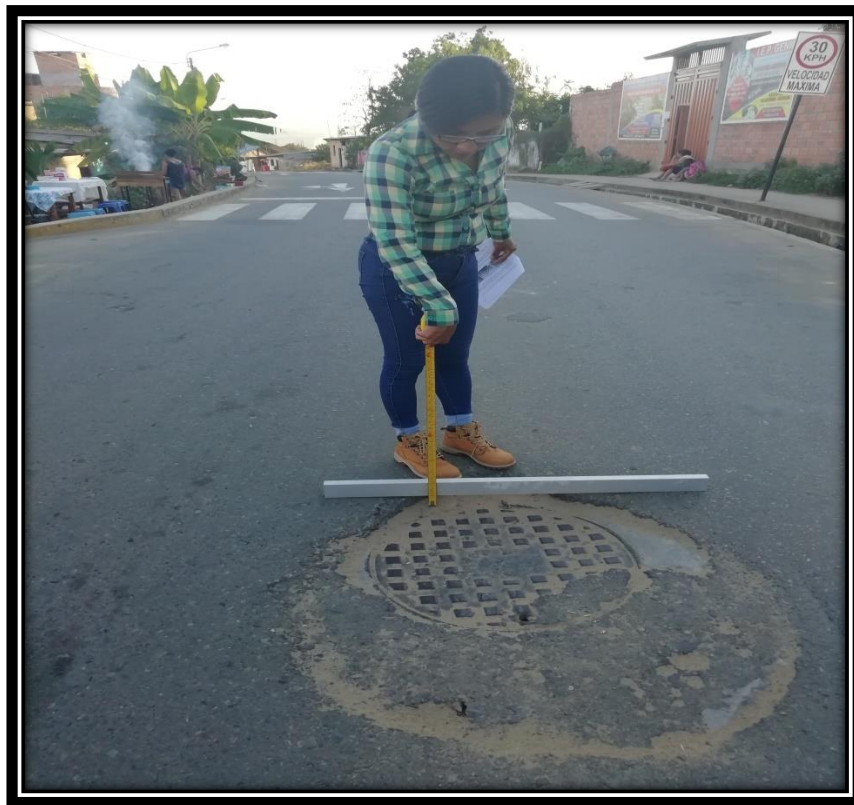
FOTO N° 03: Se observa la medición de un desnivel en el pavimento flexible.
