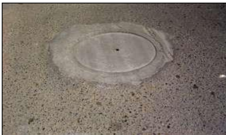
Figura 17. Parche de cortes utilitarios.
