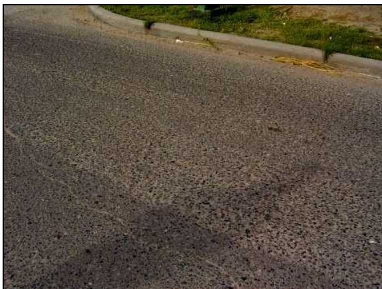
Peladura por intemperismo y desprendimiento de agregados.
