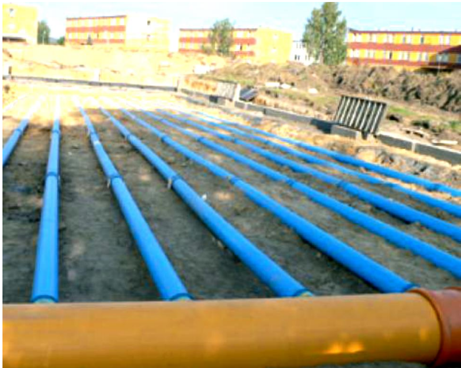
Figura N° 26: Conjunto de tubos
