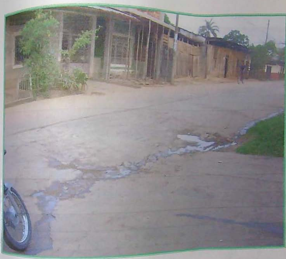
Foto N° 20.- Ca. Miraflores – Se aprecia un Pavimento Rígido (Mortero Hidráulico). Pavimento en condición muy pobre, con una transitabilidad muy pobre, se aprecian fallas por Fisuras en Bloques así como cabeza de gato. Distrito de Belén
