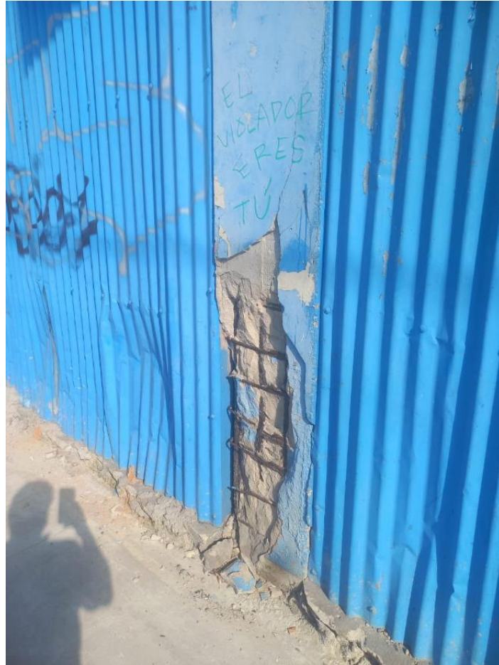
Figura N° 01: Elemento estructural (columna) expuesto en la fachada del edificio. Fuente: Imagen propia.
