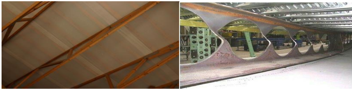
Fig. 2.15 Pandeo local en vigas de Alma abierta, Fuente: Wikipedia.org/Fallas centro de Recreación .
