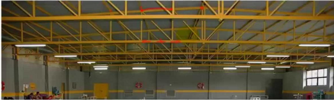
Fig. 2.17. Pandeo en elemento a compresión en armadura de techo ocasionada por presión.
