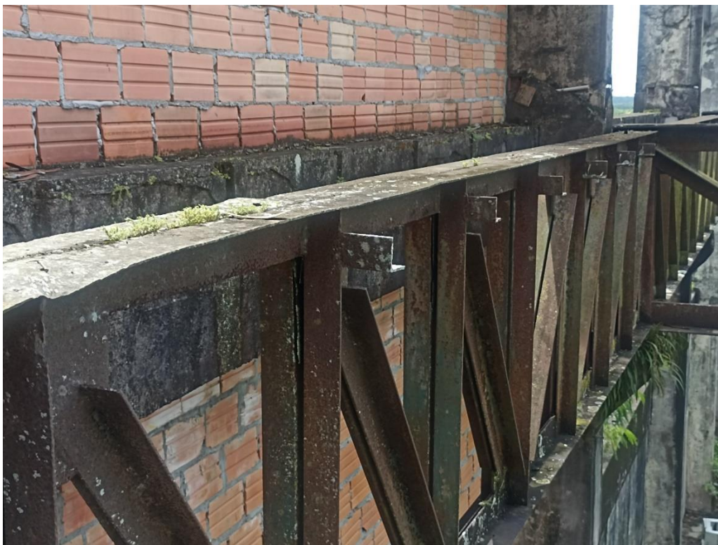
Vista de la armadura metálica lateral de la estructura en estado de corrosión
