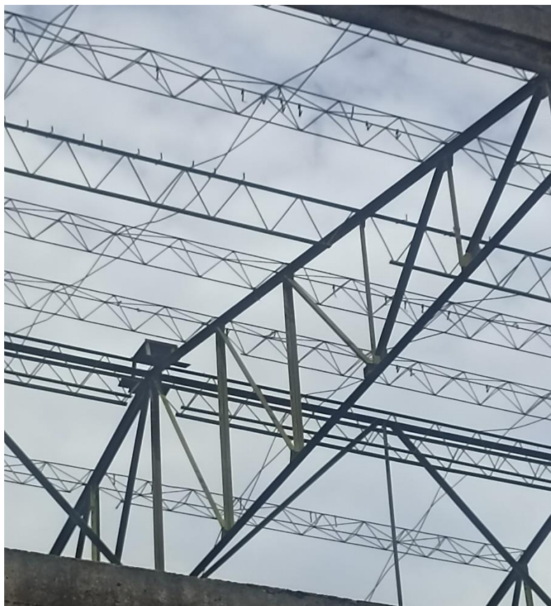
Estado de corrosión avanzando de los tijerales metálicos
