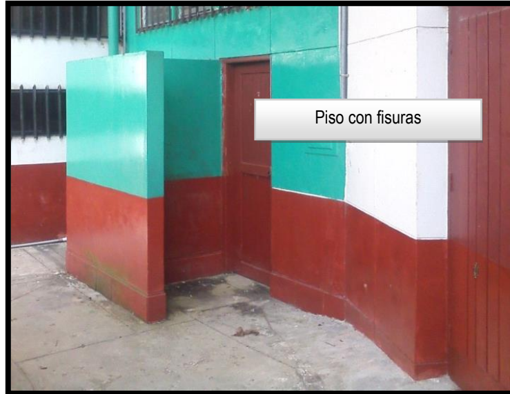
FIGURA 4 – Veredas deterioradas por fisuras Fuente: Autor
