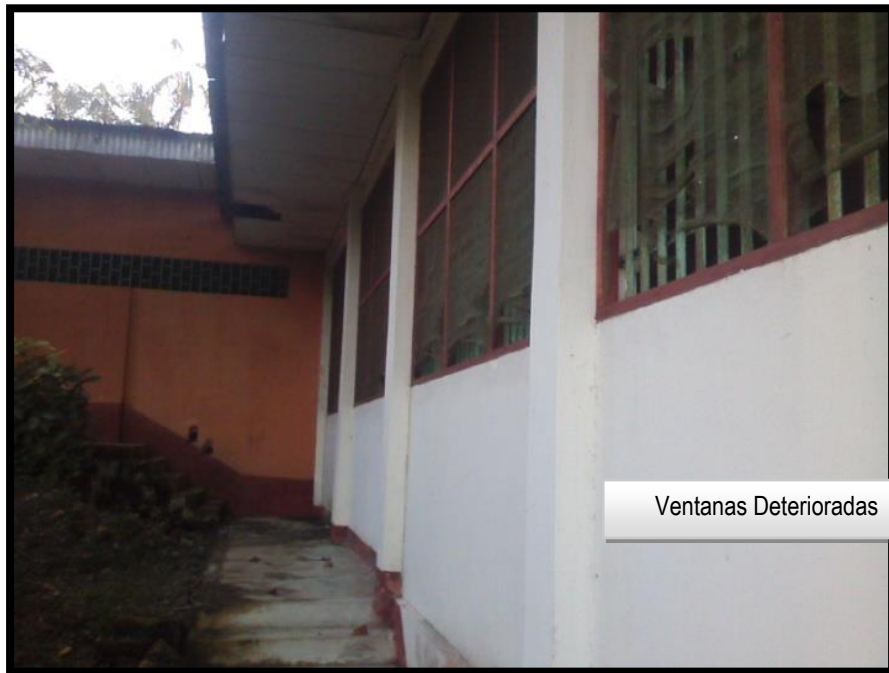
FIGURA 2 – Vista de ventanas deterioradas Fuente: Autor
