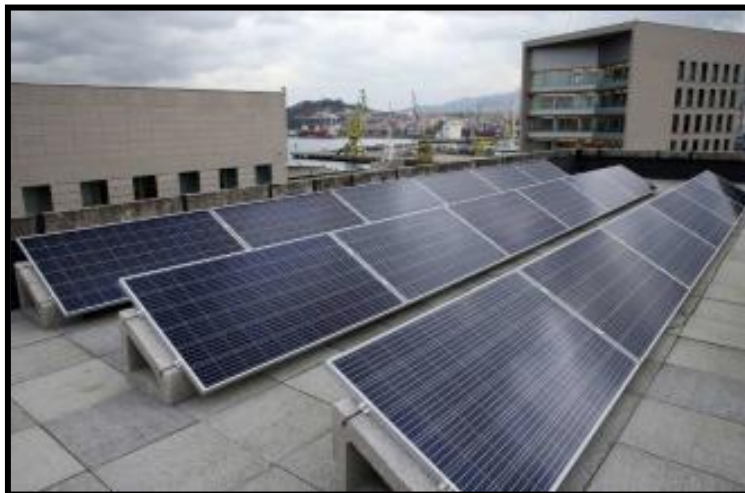
Figura 84. Ubicación de Paneles Solares en losas macizas impermeabilizadas
