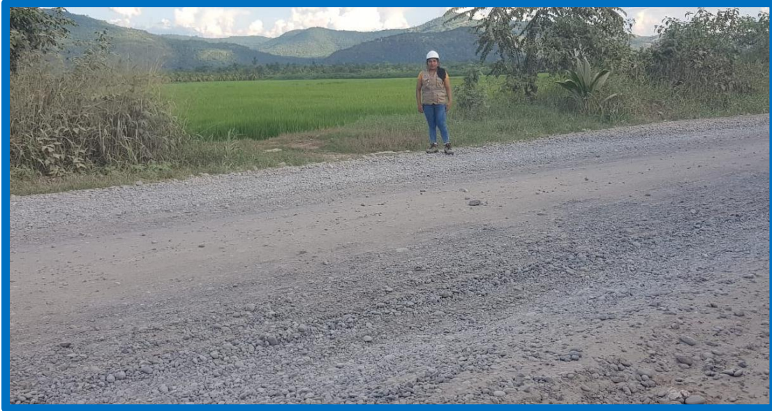
Ilustración 31: Pérdida total de pavimento por tramos.
