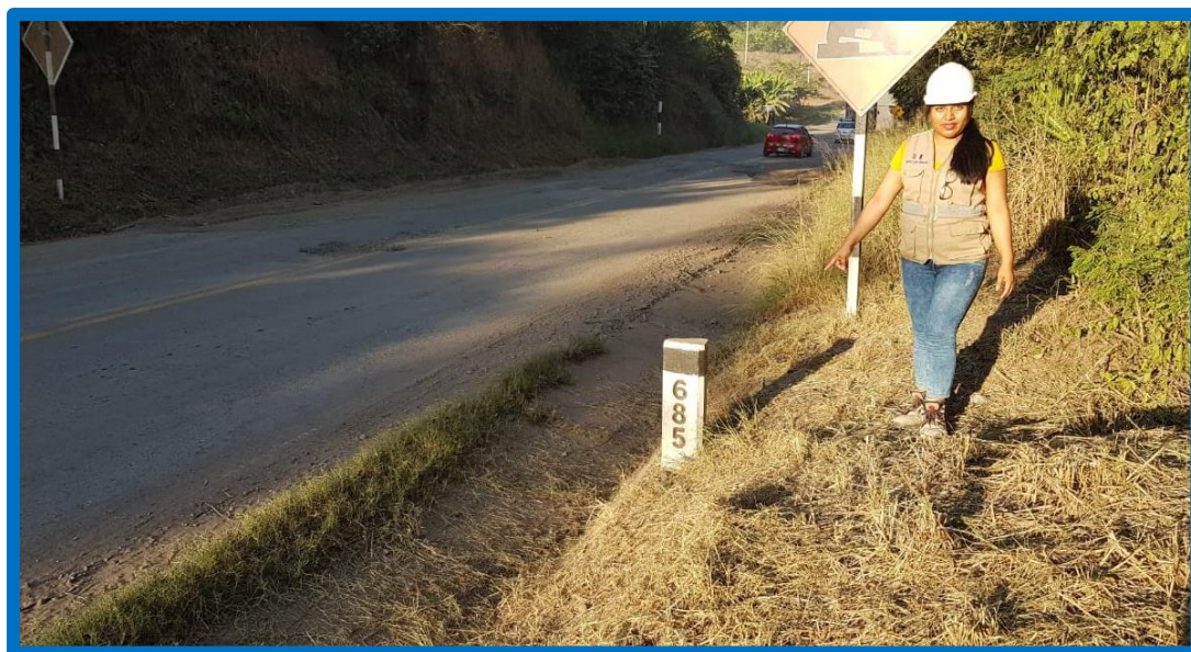
Ilustración 29: Se observa el deterioro del Pavimento.
