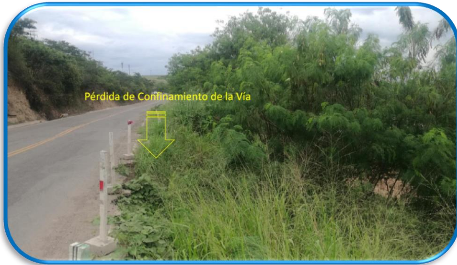
Ilustración 8: Pérdida de Confinamiento en la Vía Km 682+363 a Km 682+419
