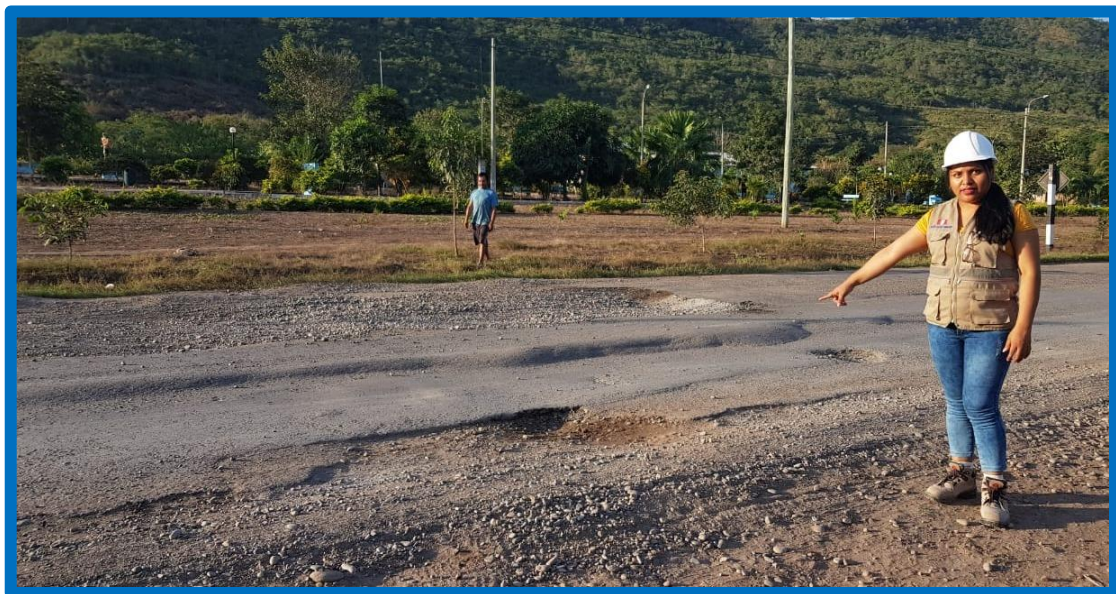
Ilustración 32: Pérdida del Pavimento parcial, resaltos y hundimientos.
