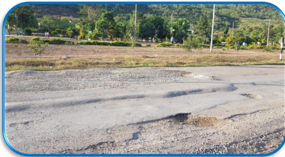
Ilustración 7: Relevamiento de Daño en la vía.
