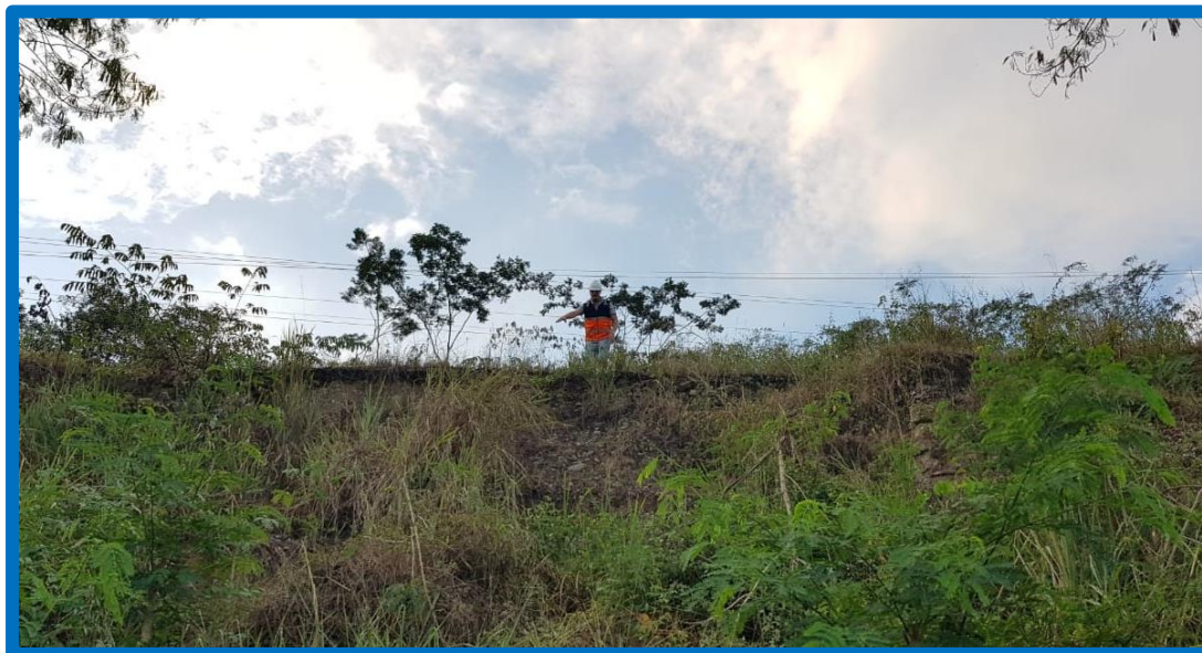
Ilustración 30: Pérdida de confinamiento de la Vía.
