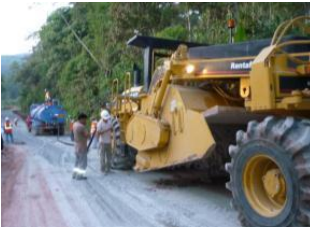
Foto N° 19. Recicladora y Camión Aljibe
